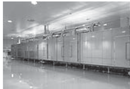
図5 本庄工場に導入された冷凍機 (出典：高橋工業(株)公式HP)
