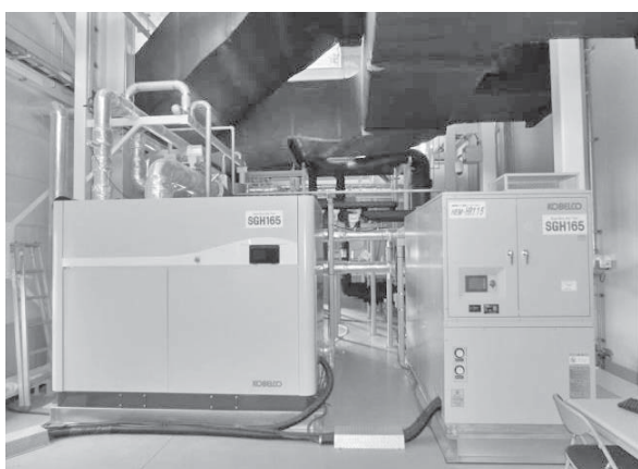
図8 ヒートポンプ開発試験設備に設置された蒸気製造ヒートポンプ
